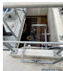
消化液処理設備
